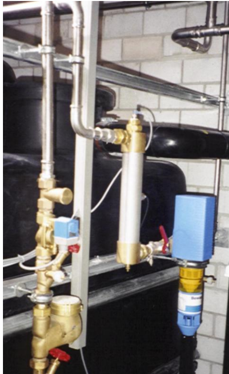
Foto 4: Blick auf die UV-Desinfektionsanlage und den vorgeschalteten rückspülbaren Feinfilter
