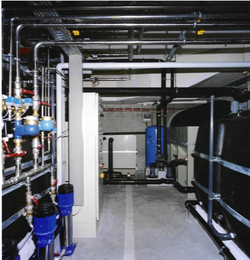
Foto 2: Blick in den (nur zwei PKW-Parkplatz großen) Betriebsraum: Rechts die Absatz- und Vorhaltebecken, dahinter die drei ersten Tauchkörperstufen mit der Hebeanlage und dem Nachklärbecken. Beim Einbau der Anlage war bereits die Parkplatzeinteilung vorgenommen worden (weißer Strich in Raummitte)
