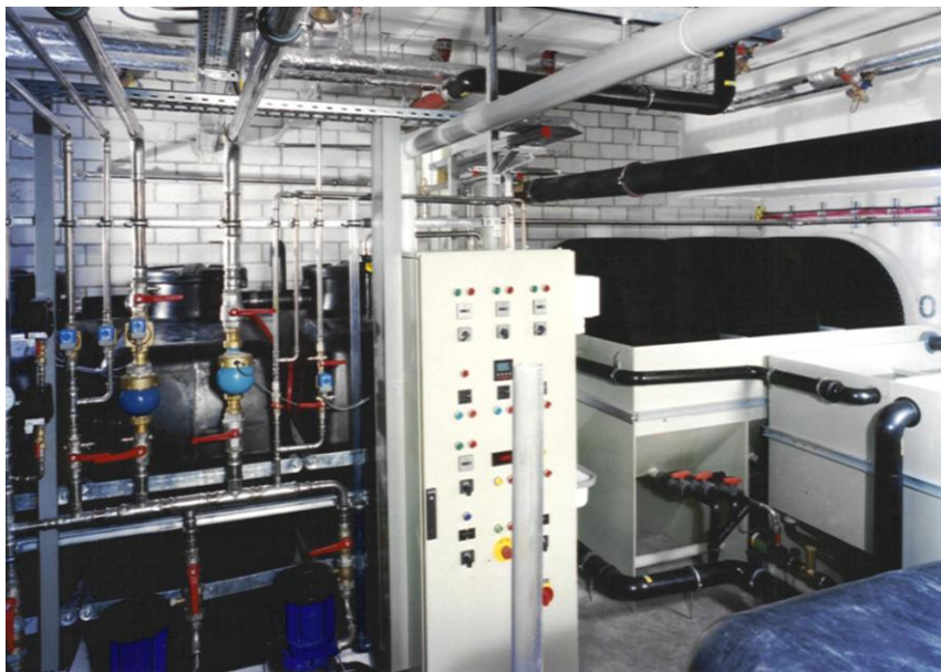
Foto 3: Blick auf die Anlagenkomponenten Nachklärbecken (rechter Bildrand in der Mitte), dahinter drei von insgesamt sechs Tauchkörperstufen sowie der Schaltschrank, die Betriebswasserspeicher und davor die Druckerhöhungsanlage mit den Ventilen und Wassermengenzählern (von rechts nach links)
